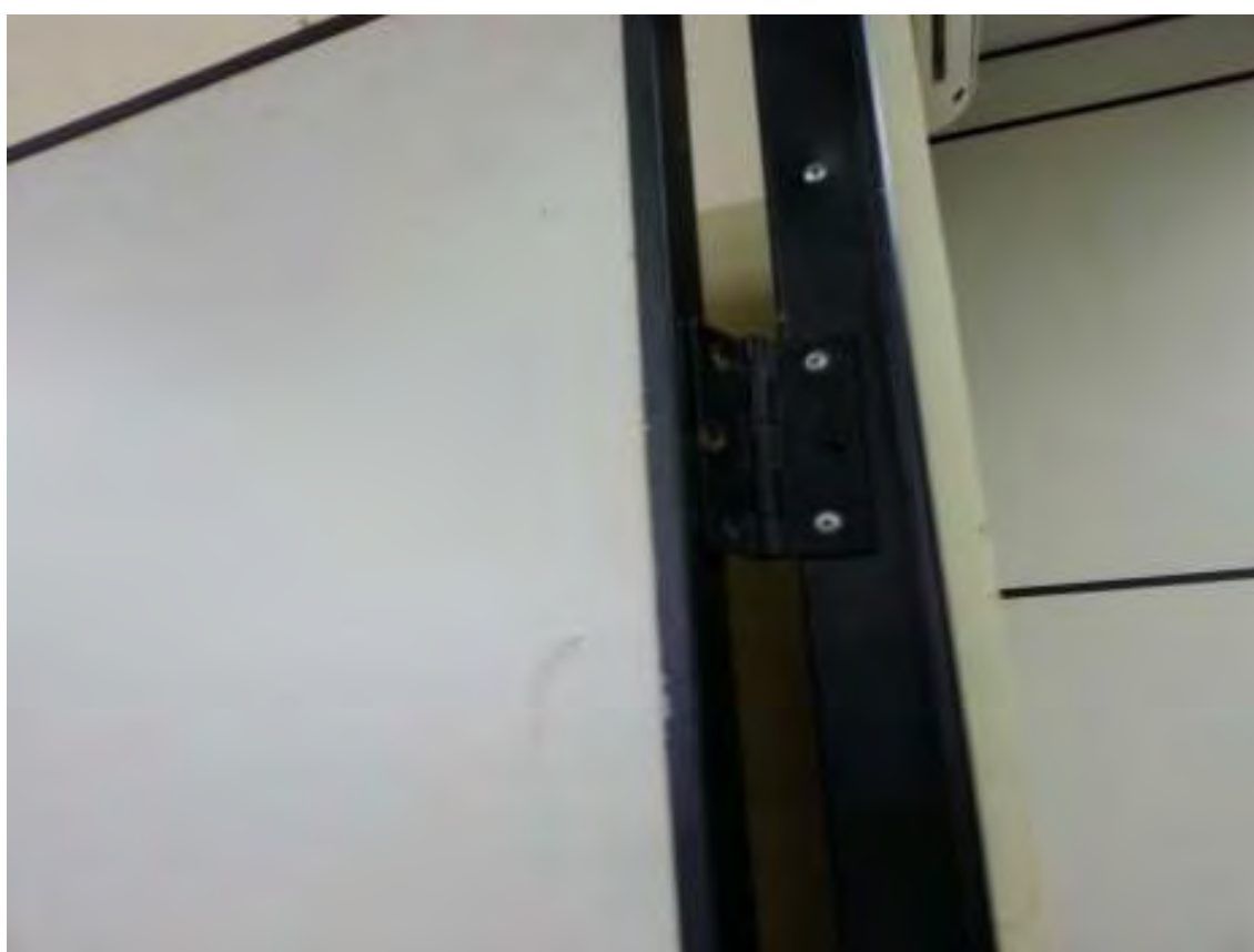
Figura 12: Porta divisória quebrada
