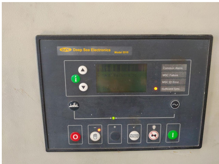
Figura 1 – Controlador DSE5510 com falha de leitura no barramento e display defeituoso.
