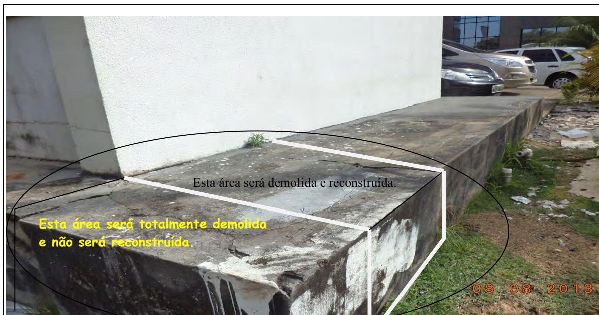
Figura 02: Calçada lateral – demolir e reconstruir
