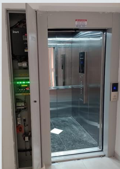
Painel de comando da cabine
