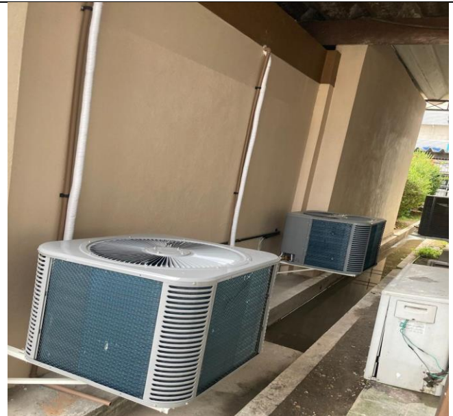
Foto 4: Condensador Sala Irradiador
