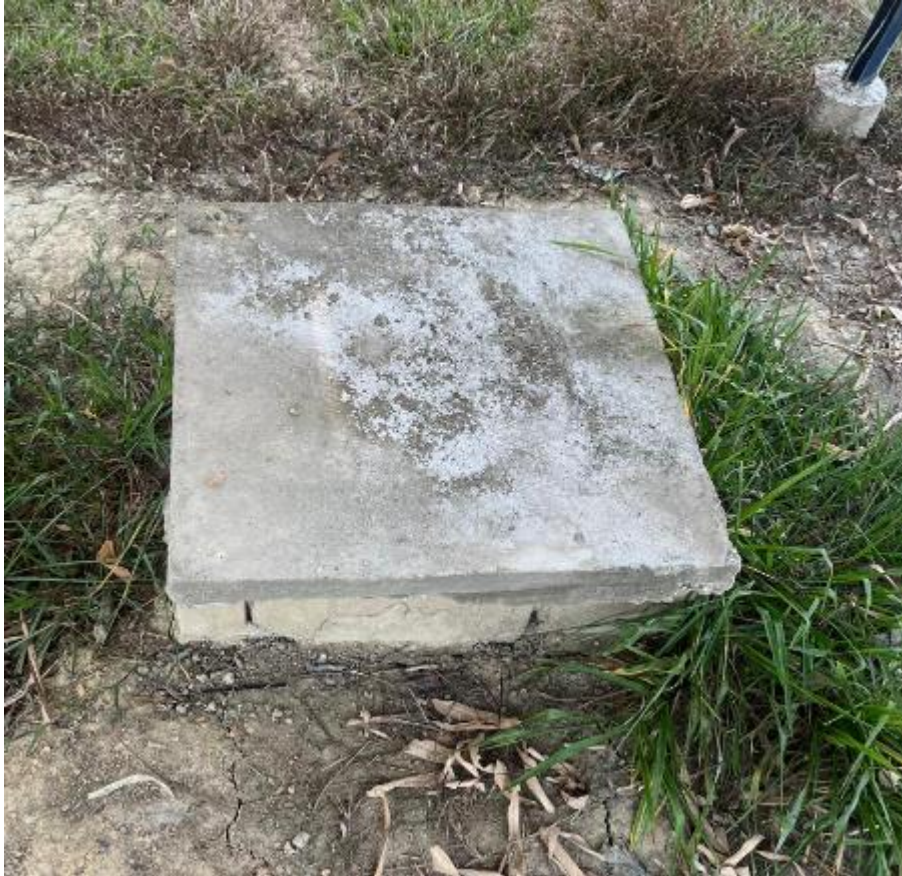
Imagem da caixa de passagem elétrica
