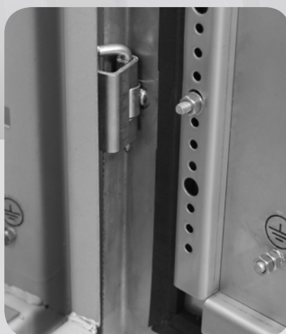
1 - Detalhes da dobradiça, pontos de aterramento e barras de fixação dos cabos
