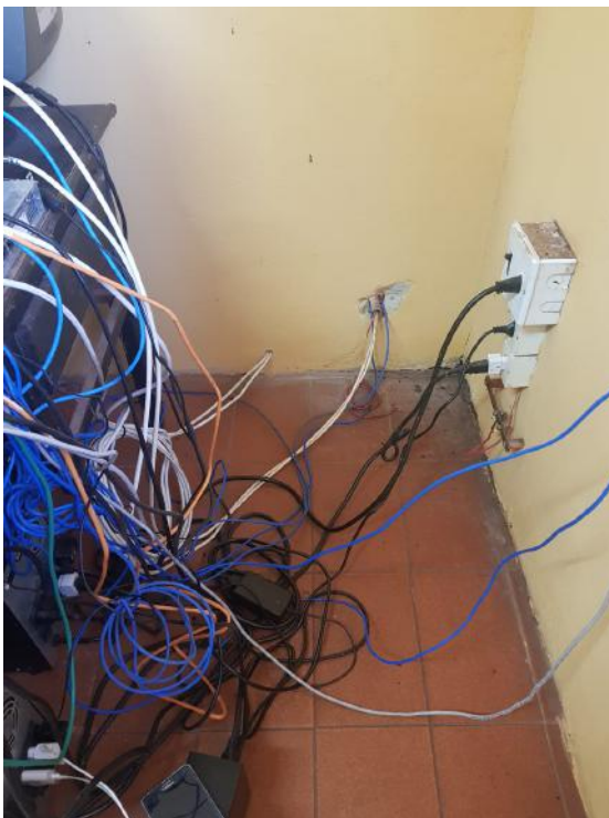
Instalação elétrica deficiente e cabos desorganizados.
