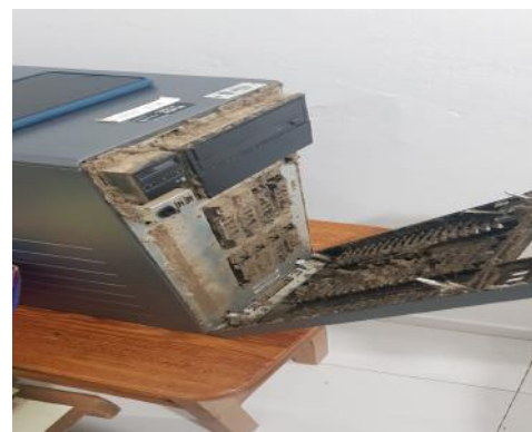
Em alguns casos os equipamentos se localizam próximo de janelas ou de acessos da rua facilitando o acúmulo de sujeira.
