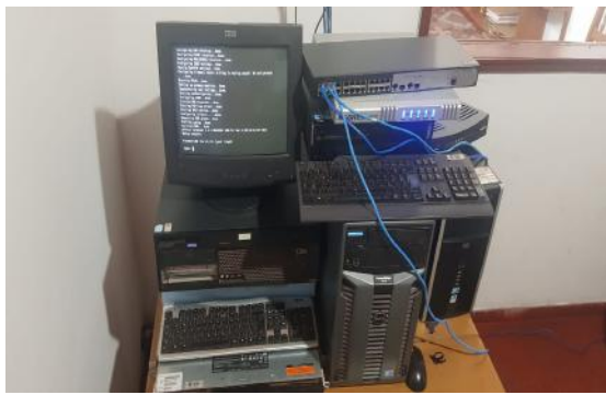
Equipamentos desorganizados, vulneráveis a qualquer ataque físico.
