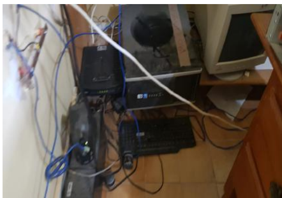
Instalação elétrica precária e exposta, com aterramento deficiente.
